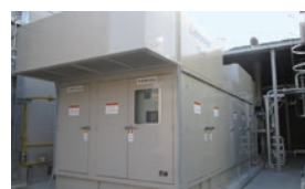
コージェネレーションシステム(本体)
