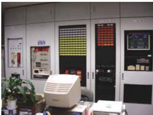
本社ビル 中央監視室 照明と空調のスケジュール運転をおこなっています。
