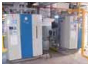
天然ガス式ボイラ
