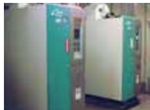
天然ガス式ボイラ
