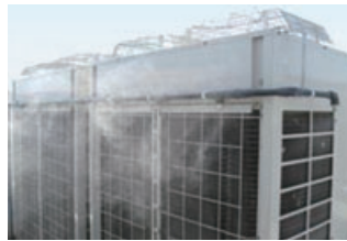
空調室外機への散水
