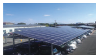
印南工場駐車場の太陽光発電パネル
