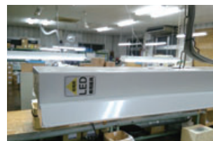
LED照明の導入
