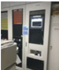
デマンド制御装置 (中央監視盤)
