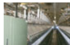
照明電力削減と糸切れ検出用照明をLED照明に変更
