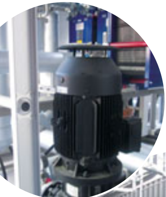
冷却水 循環ポンプ
