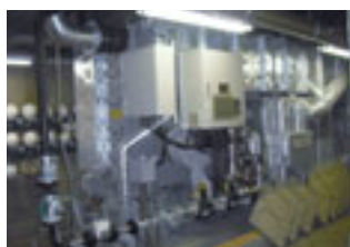
熱源機の更新
