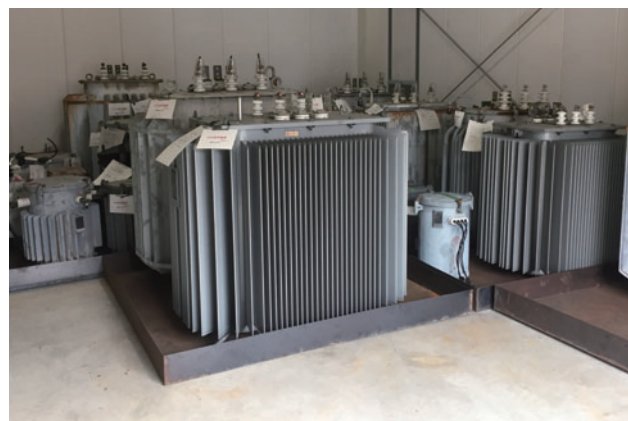
微量PCB汚染廃電気機器保管状況
